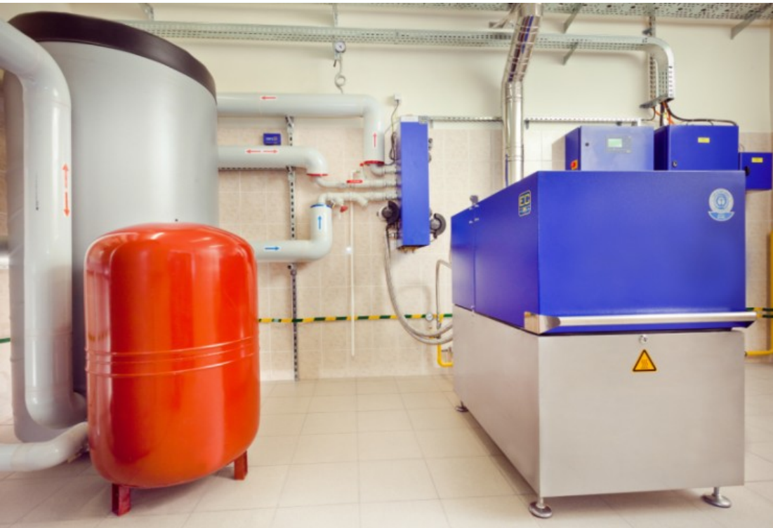
Instalacja mchp w rozlewni gazu płynnego w Pleszewie
